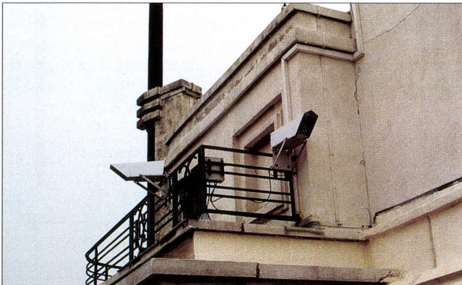
Le système Laser installé sur le toit de l'un des bâtiment du Figaro.
