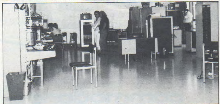
Αποψη των τεχνικών εγκαταστάσεων στον 3ο όροφο της ΕΡΤ 1, όπου γίνεται η τελική επεξεργασία εικόνας πριν την εκπομπή.
