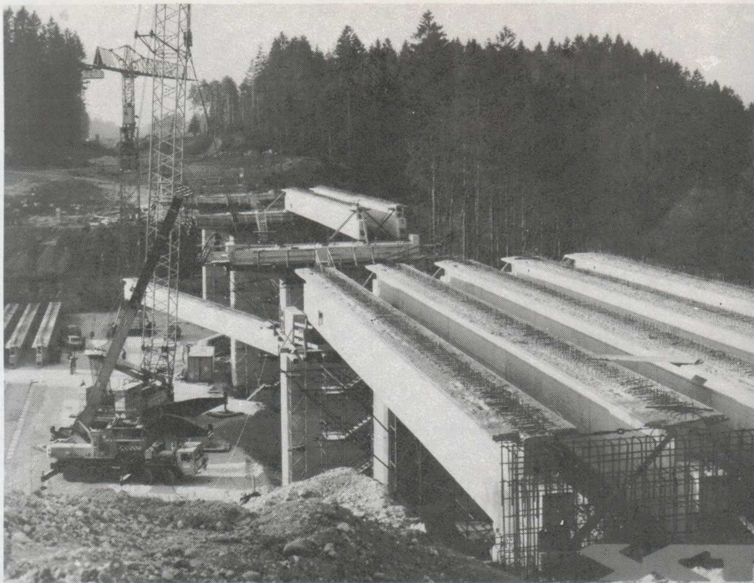
Sodobna industrijska gradnja objektov na avtomobilskih cestah zahteva visoko stopnjo uporabe računalnika. Montaža viadukta Rupovščica na trasi nove avto ceste Ljubljana–Naklo.
